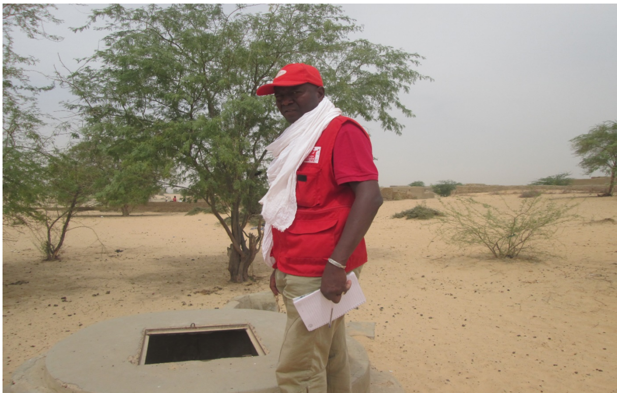
Etat des lieu du puits à grand diamètre du centre de santé communautaire de Mekore dans la commune de Tonka (Goundam)
