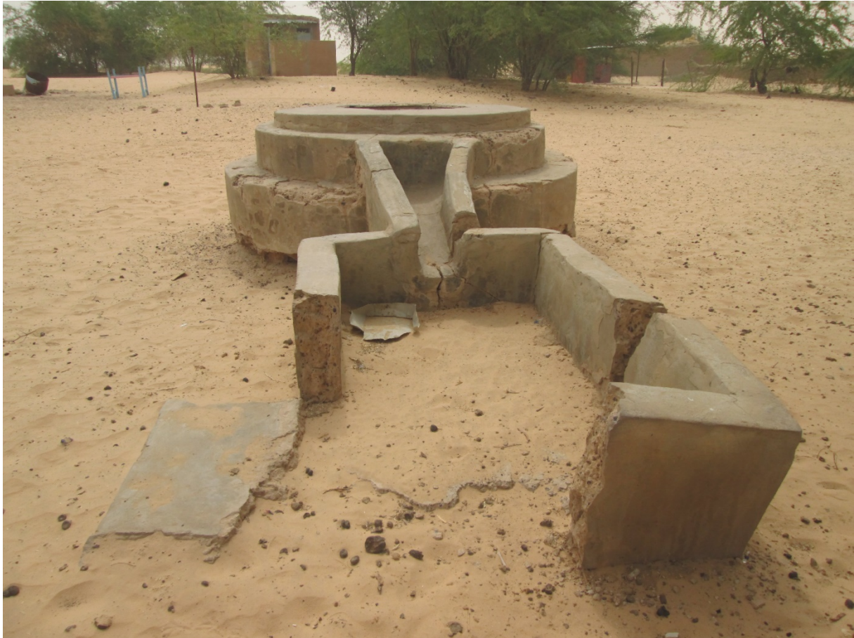
Le puits à grand diamètre en état de dégradation du centre de santé communautaire de Mekore dans la commune de Tonka (Goundam)
