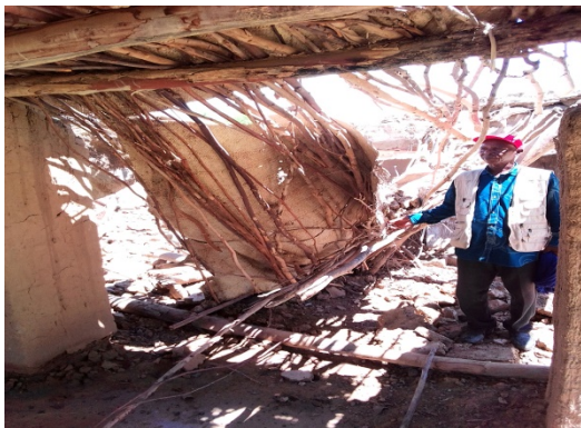
Hangar délabré du cscdm de Haibongo
